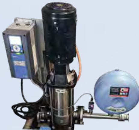
Druckerhöhungsanlage mit Kreiselpumpe und FU-Steuerung
